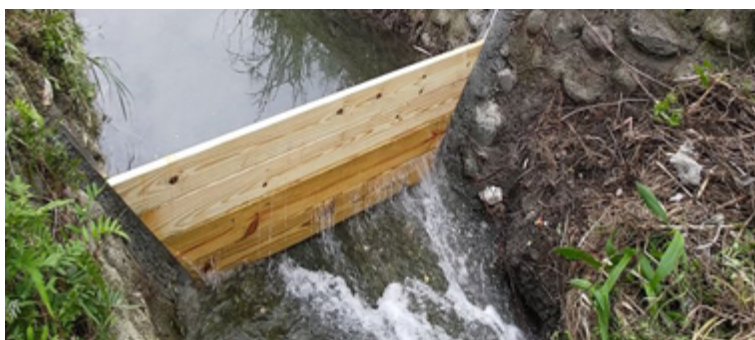
圖七 截水設施擋水設施
